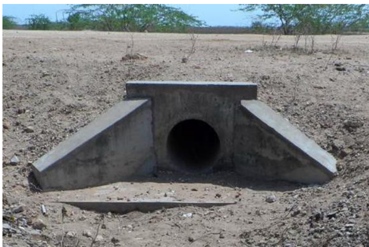
Figure 39 Séparation des murs des ailes du mur de tête d'un ponceau relativement neuf
