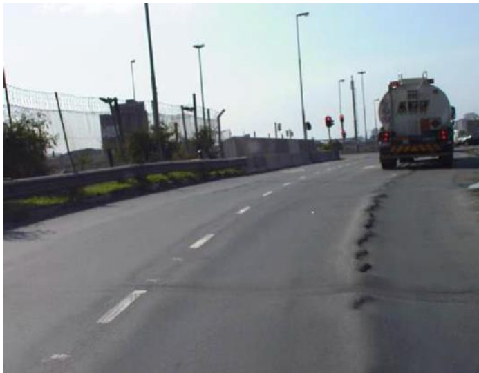
Figure 11 Orniéage et déformation de l'asphalte résultant des températures élevées et de la charge du trafic
