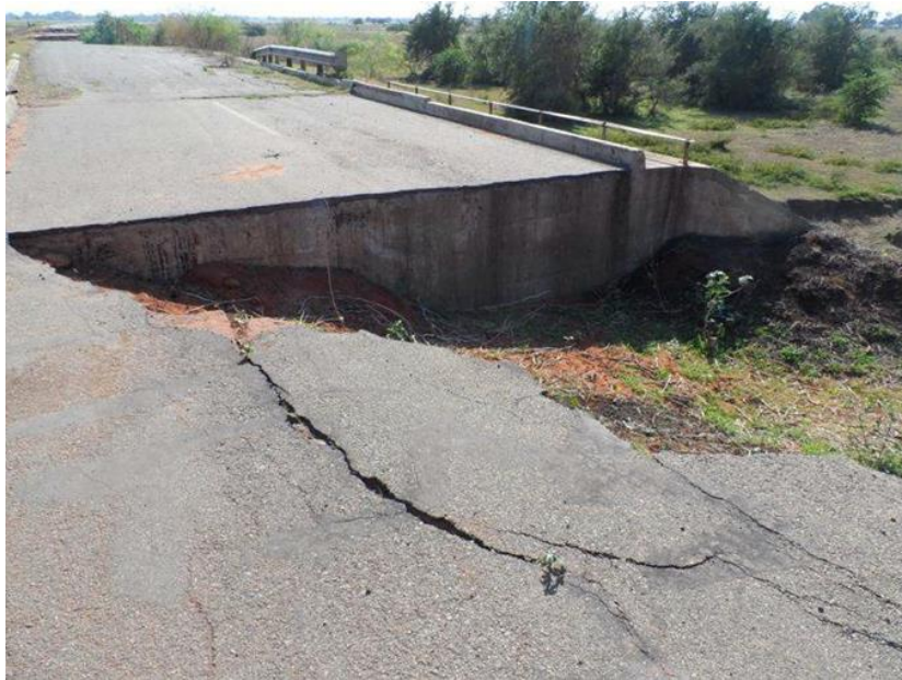
Figure 35 Dommages causés par l'inondation à la culée du pont après le débordement de la berge
