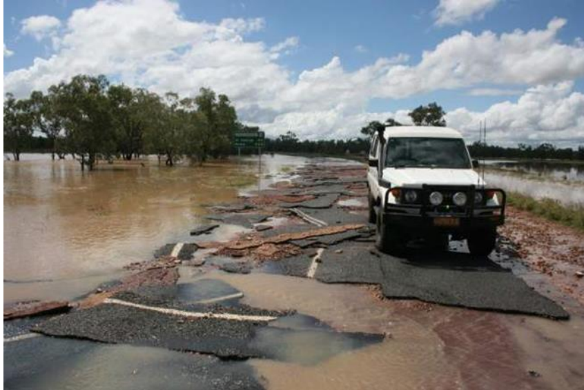
Figure 9 Perte de surface causée par de fortes pressions de soulèvement lors d'une inondation 12
