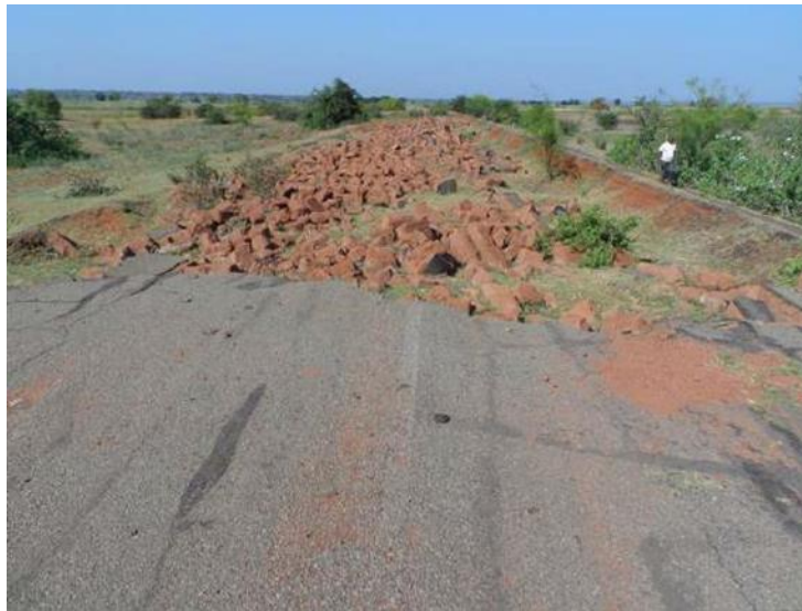
Figure 19 Perte complète du remblai et de la route en raison des conditions d'écoulement turbulentes lors du débordement et de la faiblesse de la couche de fondation
