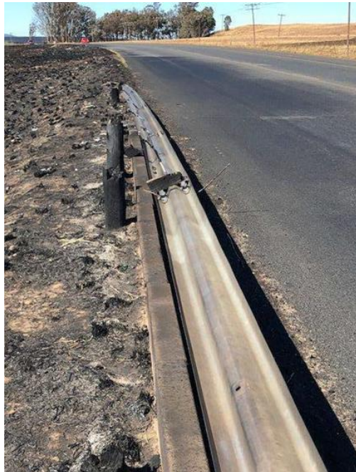
Figure 40 Dommages aux poteaux de glissière de sécurité et aux revêtements bitumineux causés par les incendies
