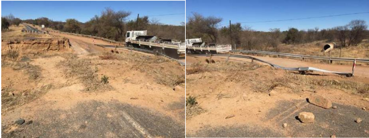
Figure 36 Dommages causés à un ponceau en acier après la tempête avec perte totale du remblai. La photo de droite montre l'emplacement final du tuyau métallique
