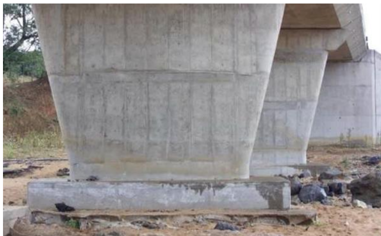
Figure 38 Affouillement localisé autour de la semelle de la pile du pont
