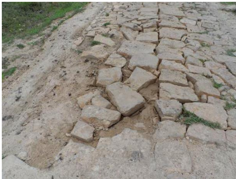
Figure 14 Dommages subis par une route en pierre emballée à la main après une inondation
