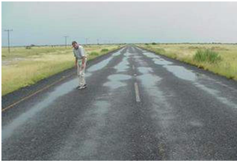
Figure B.6 Manifestation typique de l'effondrement du sol support
