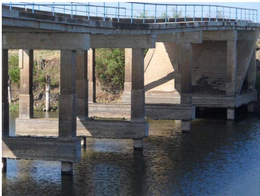
Figure 37 Affaissement du tablier du pont dû à l'affouillement de la pile de support
