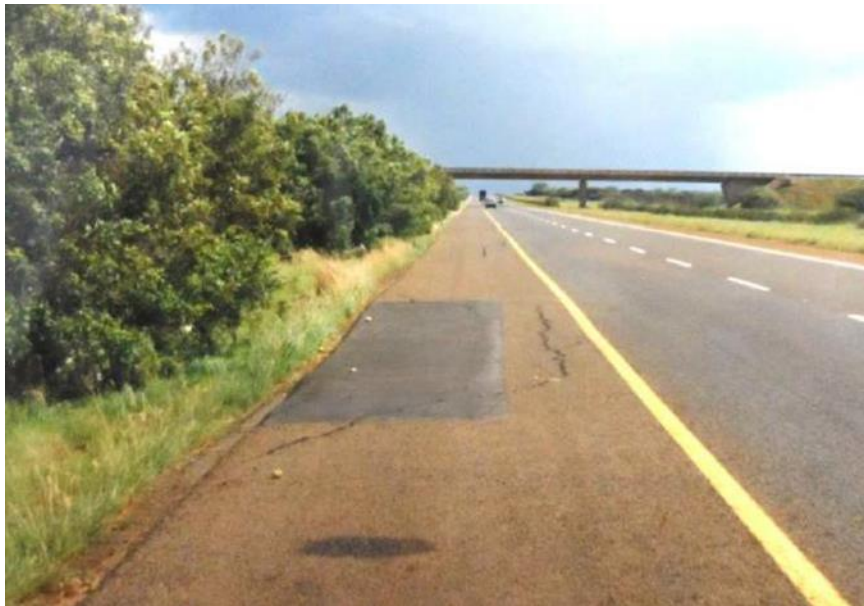
Figure 28 Exemple de fissuration due à la déshydratation causée par des arbres à côté de la route, entraînant un affaissement de plus de 150 mm dans la zone rapiécée
