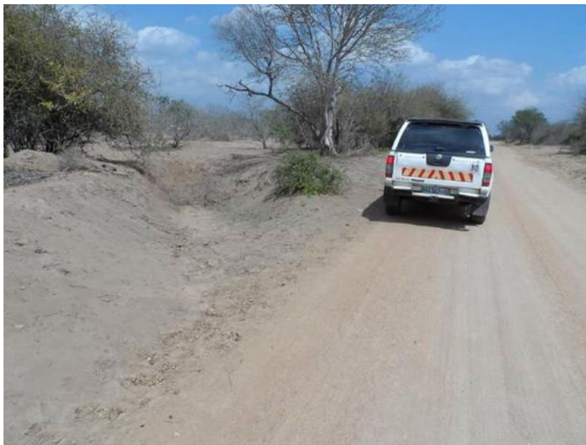
Figure 34 Un drain à onglet court qui ne peut pas dissiper efficacement l'eau collectée
