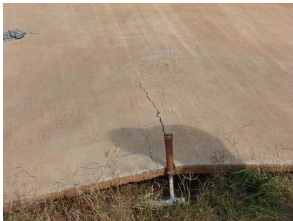
Figure 13 Soulèvement d'une route en béton armé continu à couche mince résultant de la dilatation thermique
