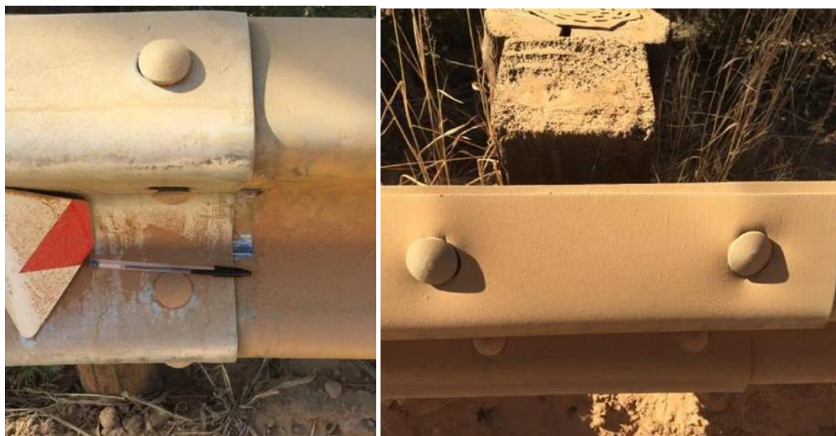
Figure 41 Effet de la dilatation des glissières de sécurité métalliques : a) desserrés et b) serrés de manière à éviter les mouvements thermiques et à provoquer des déformations (mouvement quotidien visible sur la photo de gauche
