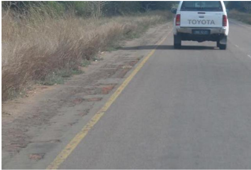
Figure 10 Détérioration de l'accotement du joint à un seul éclat par rapport au joint à deux éclats sur la chaussée
