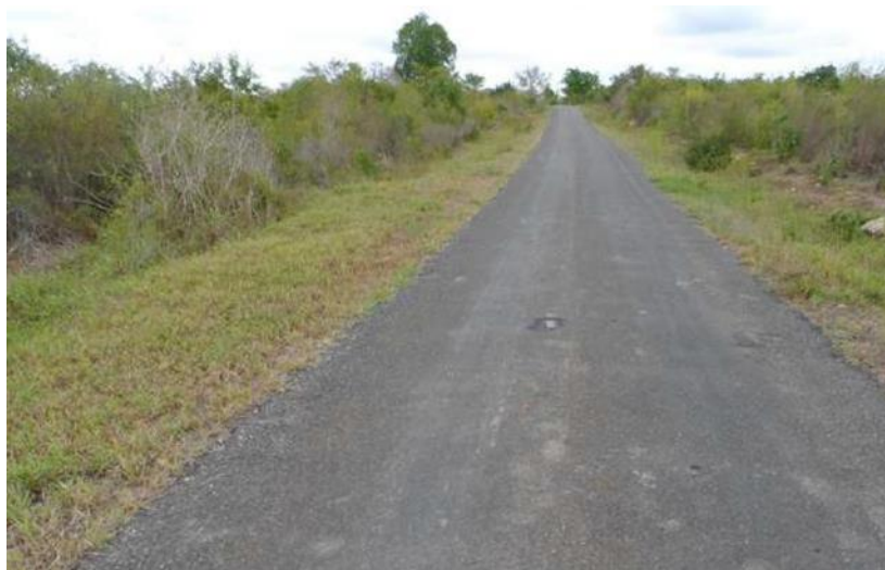
Figure 30 Accotements gazonnés et encombrés réduisant à néant l'efficacité du drainage de la surface de la route
