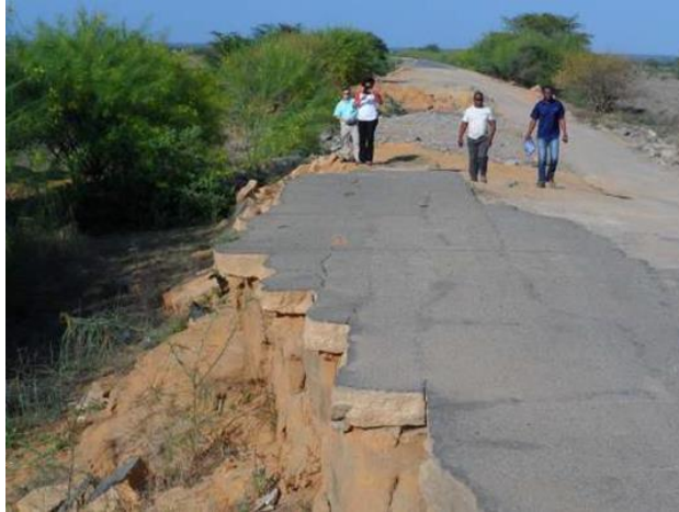
Figure 18 Sous-coupe et effondrement de la chaussée dus à l'érosion du talus
