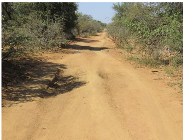
Figure 5 Route en terre typique non aménagée montrant les dommages causés par la rétention d'eau
