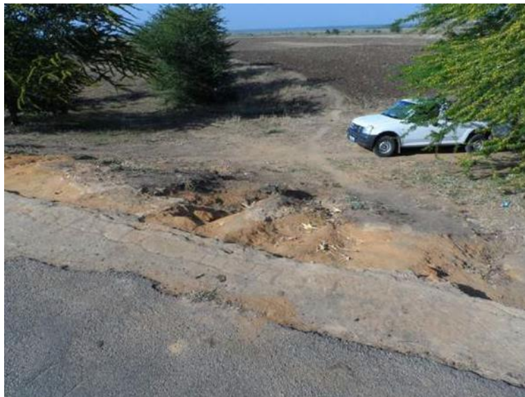
Figure 23 Érosion causée par l'accès des véhicules, des piétons et des animaux hors de la route
