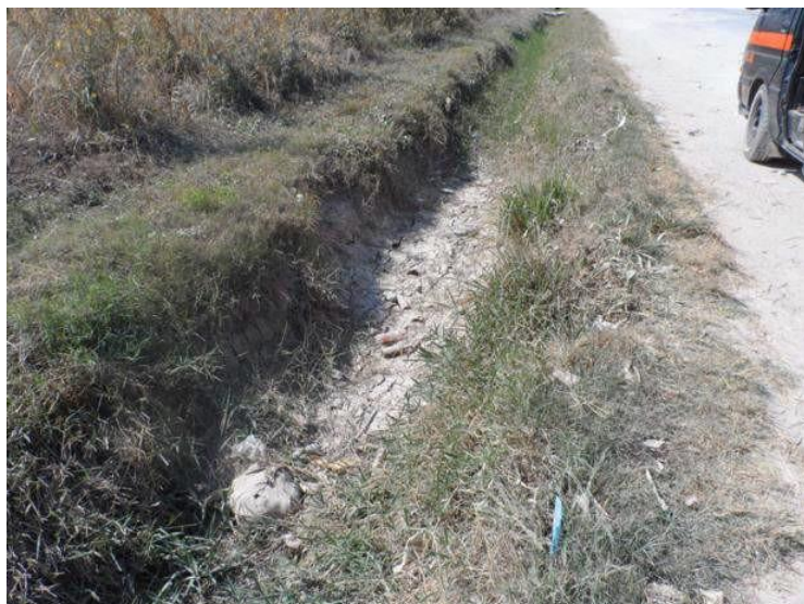
Figure 12 Preuve de l'accumulation d'eau dans le drain latéral
