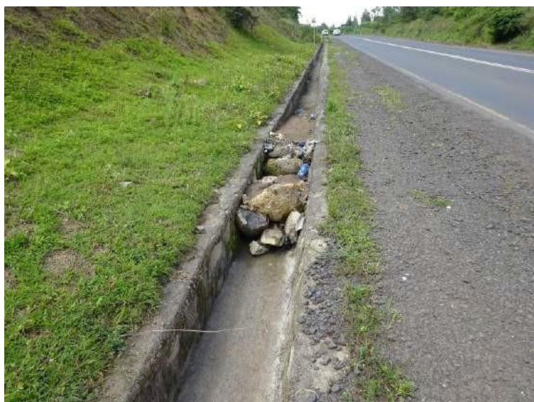
Figure 16 Zone non revêtue entre le joint d'étanchéité et le drain revêtu permettant l'accès de l'eau dans la chaussée (noter également le mauvais entretien du drain latéral)
