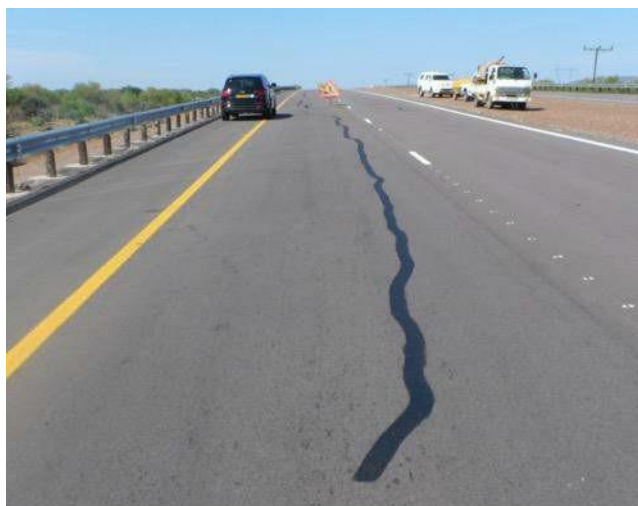
Figure 25 Fissuration du remblai due à une contrainte excessive
