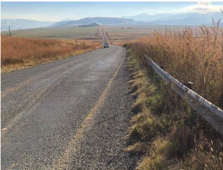
Figure 29 Végétation épaisse le long de la route indiquant un entretien insuffisant (noté 5/5)
