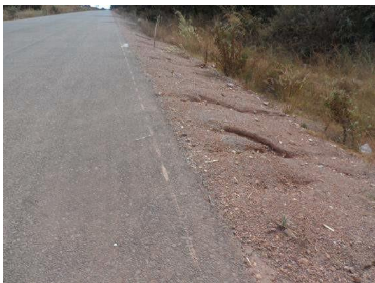
Figure 27 Mauvaise finition d'une route nouvellement construite
