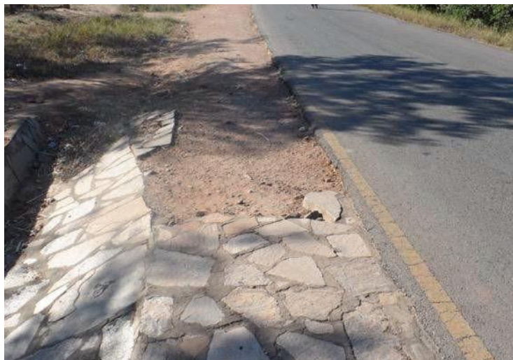
Figure 28 Mauvaise finition des travaux de protection entraînant une défaillance - pas de poutres "d'ancrage
