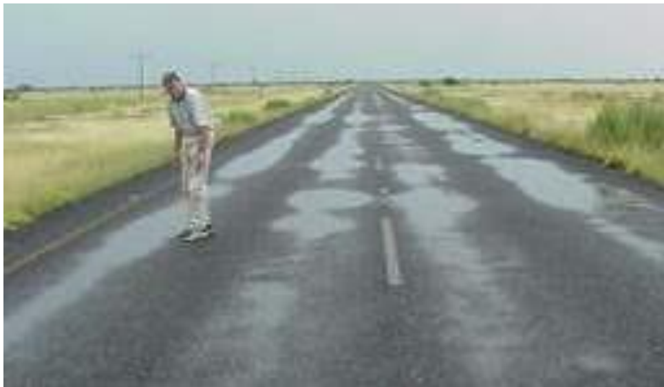
Figure 8 Manifestation typique de l'effondrement des sols dans une route revêtue
