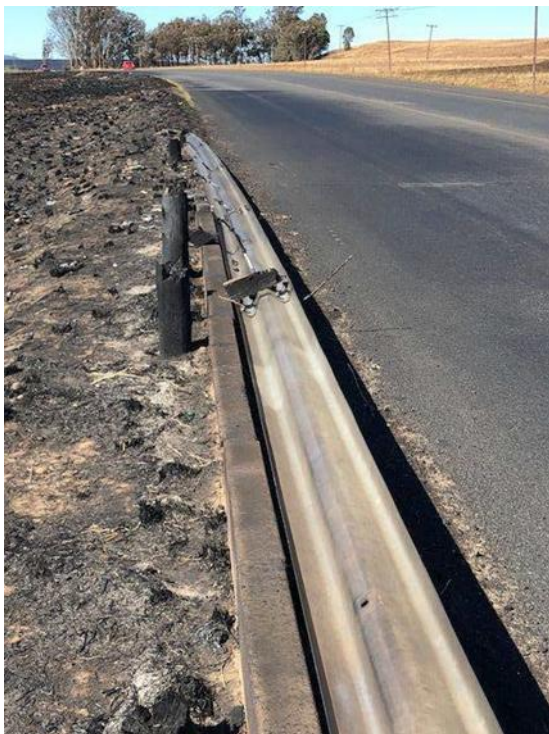
Figure 31 Dommages causés par un incendie aux poteaux de garde-corps et au revêtement bitumineux
