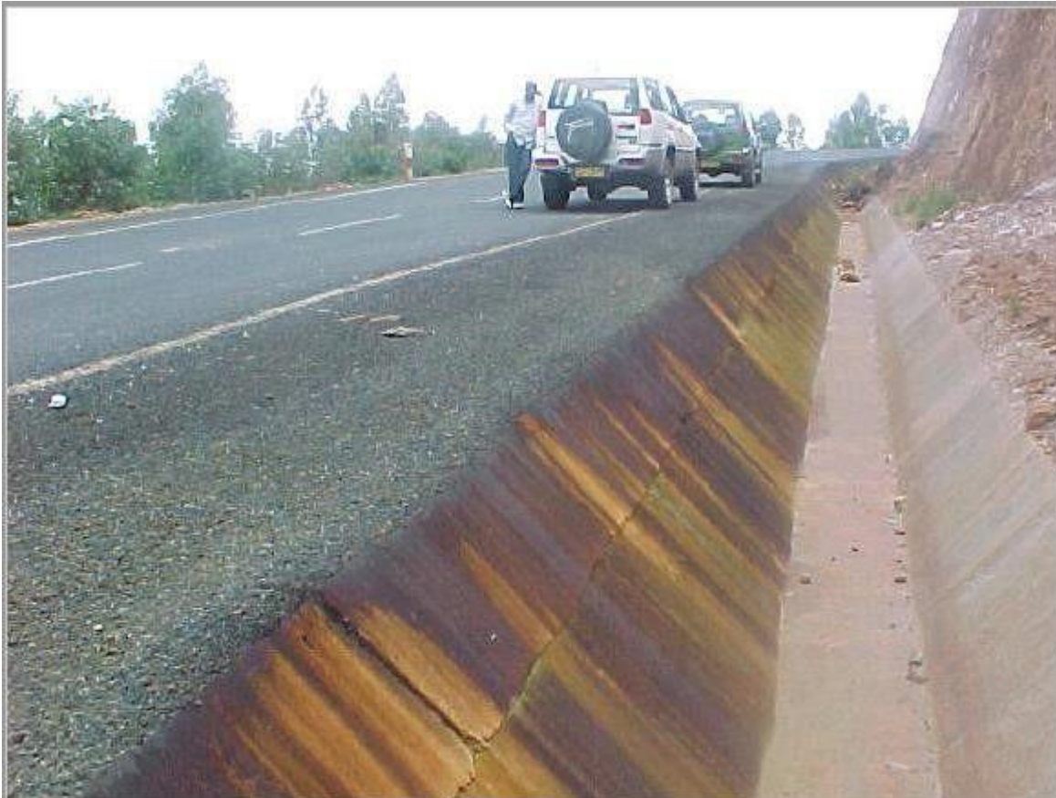
Figure 9 : Un exemple de coloration jaune/brun d'un drain latéral en béton due à la présence de sulfures
