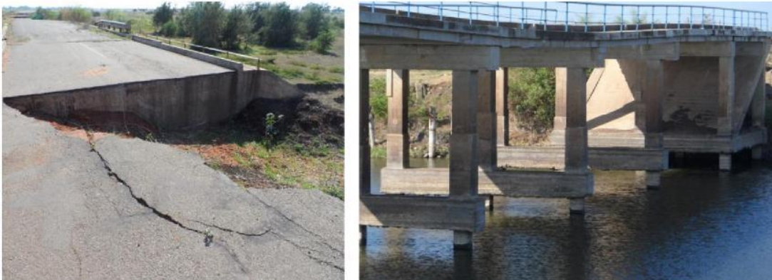
Figure 8 Dommages causés par les inondations à l'approche du pont et à la structure du pont
