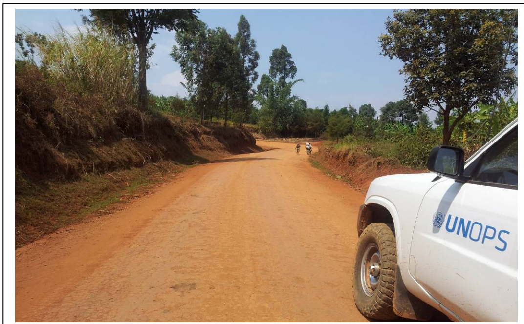
Route Burhale - Shabunda, tronçon 1 : Plate-forme limoneuse plastique
