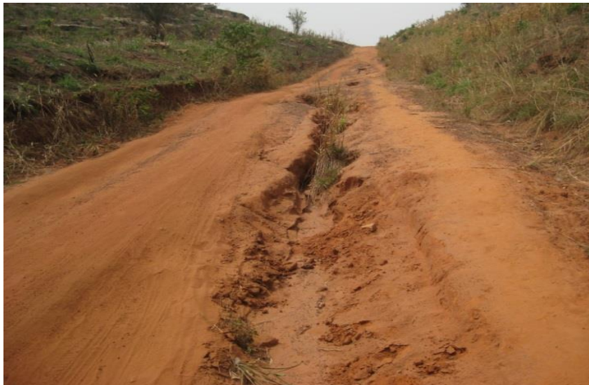
Ravinement sur le tronçon Teiwanya-Sekasua
