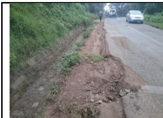
Figure 2-2: Mauvais - Écart entre le revêtement de surface et le revêtement du drain
